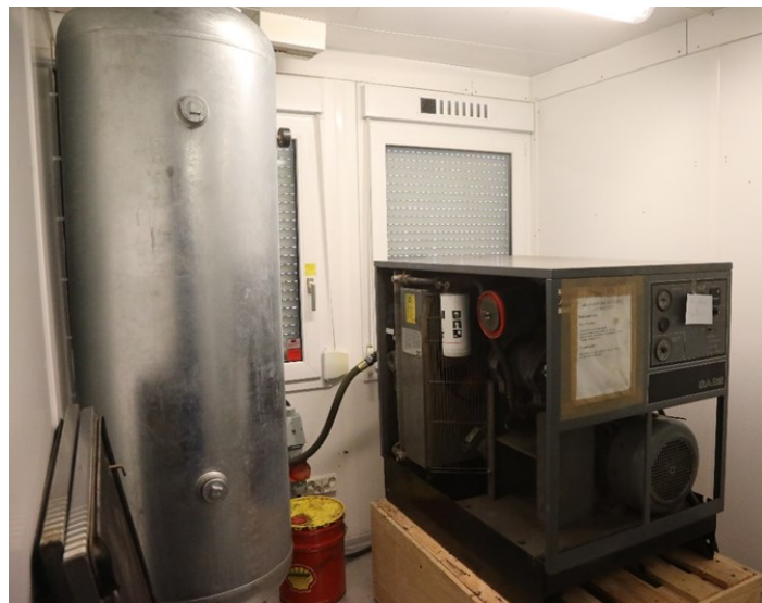
Kompressor og tank installert i et av rommene .
